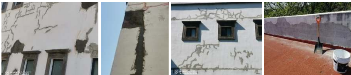
Fotografía 31. Trabajos de reparación de muros de los edificios de Ingenierías, Posgrado, Gestión y Centro de Información. 101
