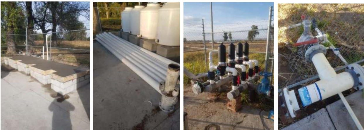
Fotografía 36. Reservorio de agua en el Tecnológico de Roque
