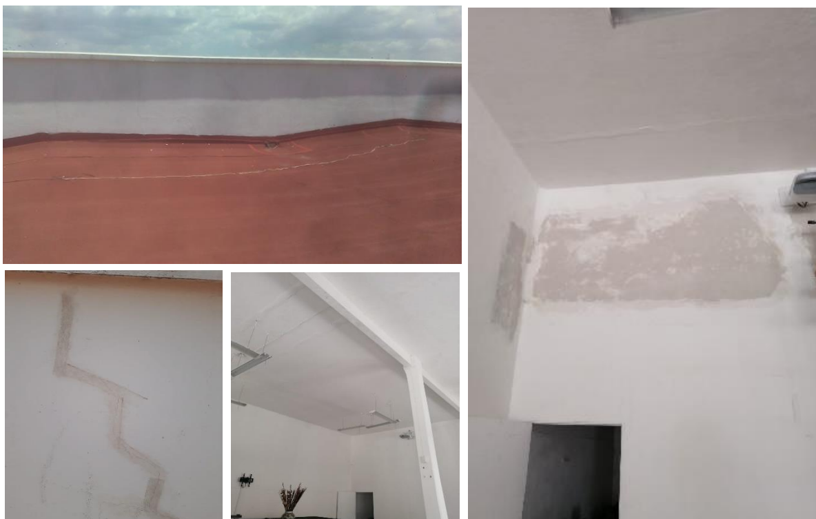
Fotografía 37. Trabajos de reparación de muros de los edificios de Ingenierías, Gestión y Centro de Convenciones.
