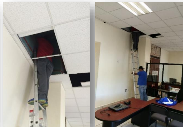
Fotografía 86. Cableado Subdirección Académica 2015.
