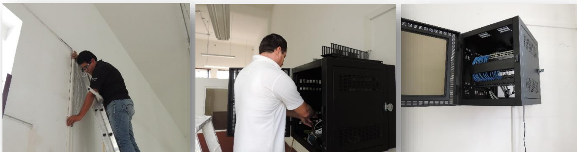
Fotografía 87. Cableado de Sistemas y computación 2014.
