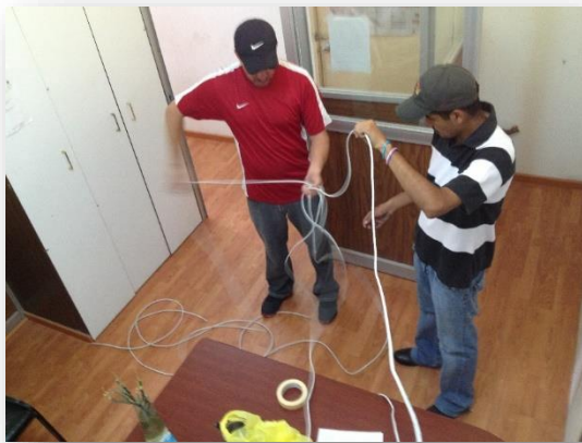
Fotografía 85. Cableado al Departamento de Vinculación 2013.
